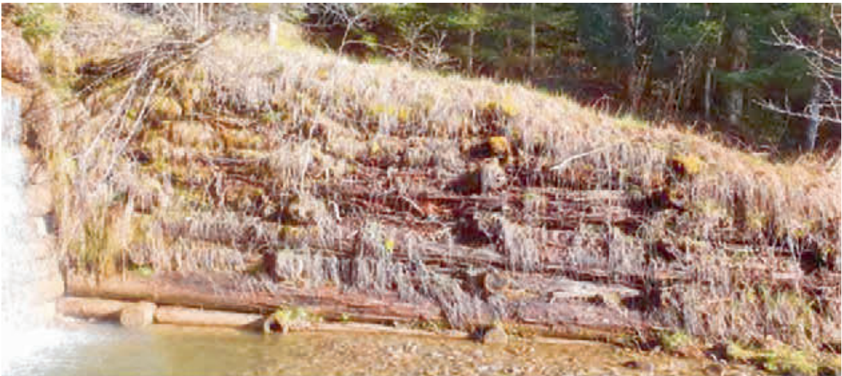
Bild 2: Vermorschungen und mechanische Abnutzung zwischen den Leitwerken
